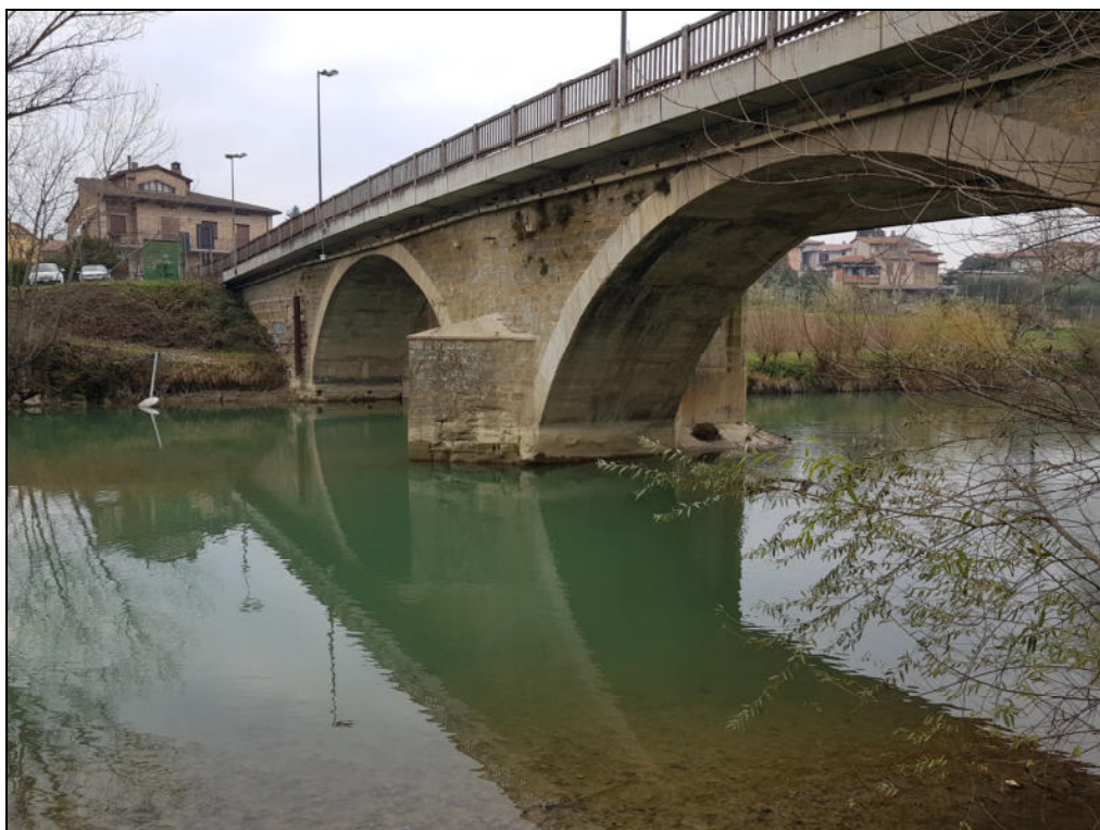
Foto della pila in alveo del Ponte Rosciano – il livello attuale scopre le fondazioni
